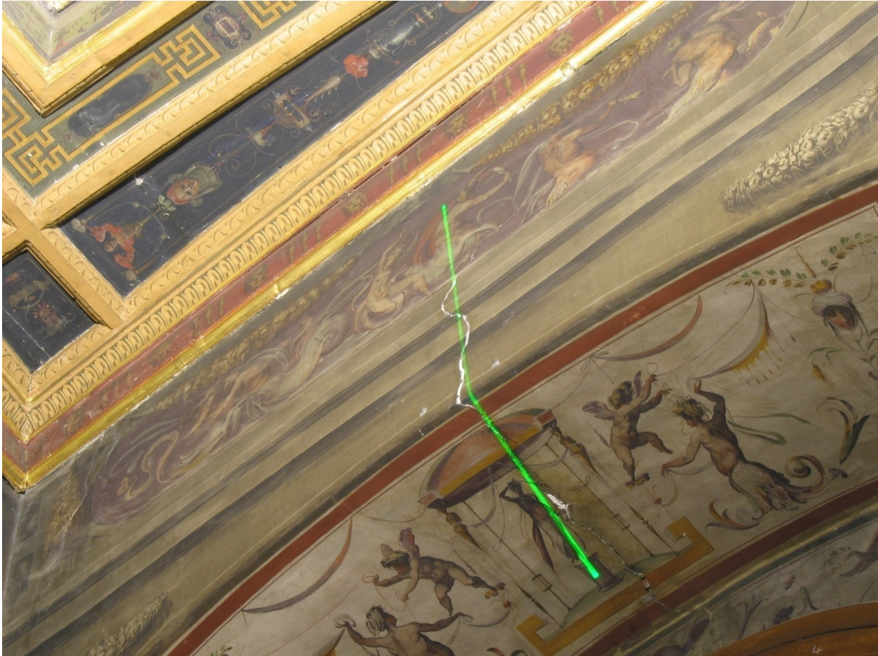
Figure – Laser scanning of crack in Stanza Dei Elementi in the Palazzo Vecchio.
